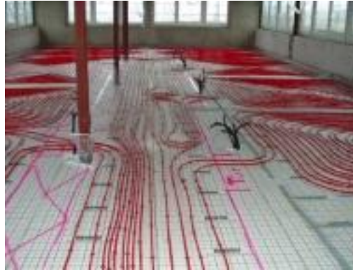
Fußbodenheizung: Rohrregister unter Estrich
